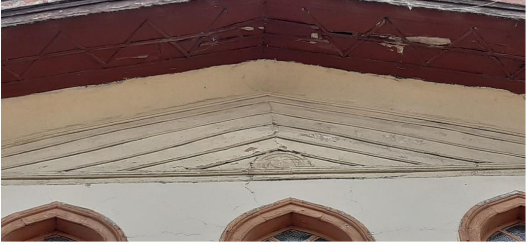
Görsel 121: Pazar Eski Hükümet Konağı Çıkma Üzerinde Yer Alan Üçgen Alınlık
