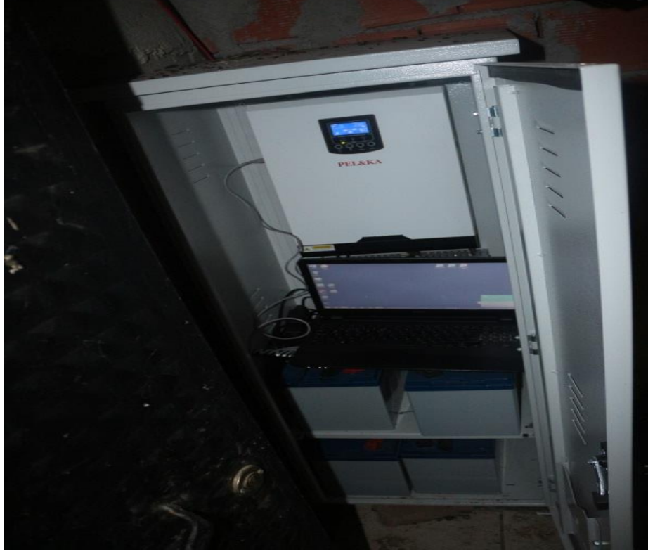
Şekil 3.13 Sulama amaçlı kurulan PV sistemin inverter kurulumu
