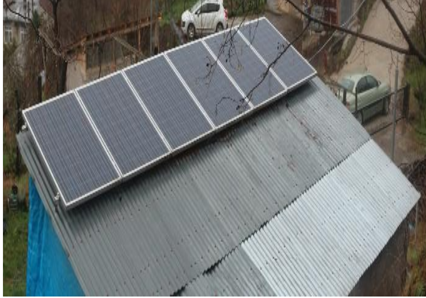
Şekil 3.3 Sulama amaçlı kurulan PV sistemin fotovoltaiik panelleri
