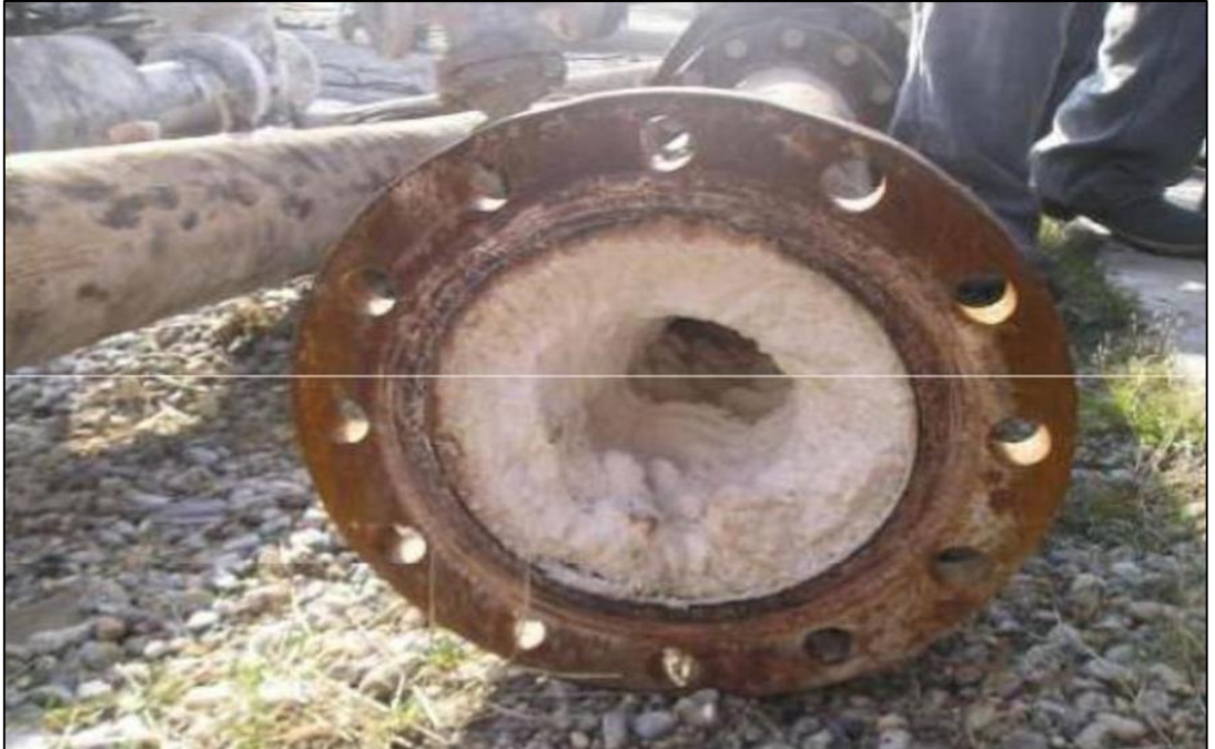
Şekil 3.14 Jeotermal Borularda Kalsiyum Karbonat ( \text{CaCO}_3 ) Kabuklaşması
