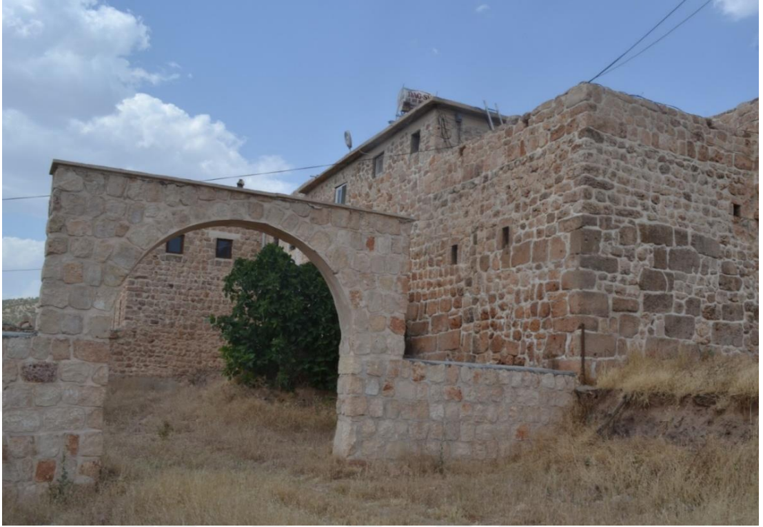
Şekil 5: Dayro da'Slibo Manastırı'nın güneybatı köşesinde yer alan Mor Heworo Kilisesi'nden bir kesit. (Fotoğraf: Sami DİK)
