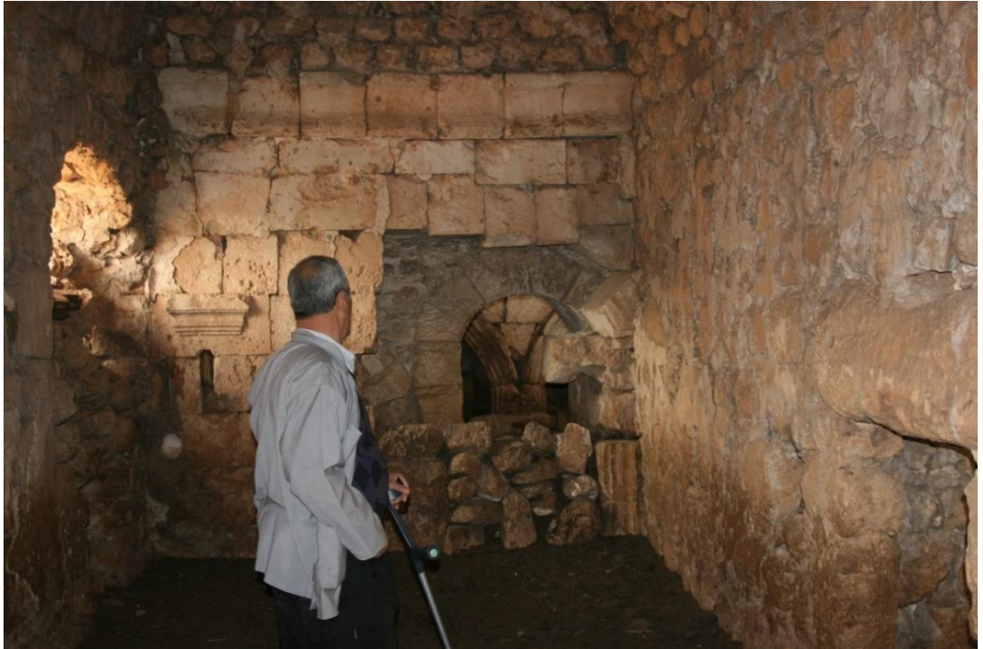
Şekil 10/b: Beṭ Man'am Köyü'ndeki Mor Aho da'Fnoṭ Manastırı'nın kilise bölümünün narteks kısmı. (Fotoğraf: Midyat Papazı İshak ERGÜN)
