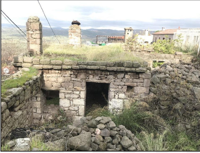
Şekil 3. 33. Yapılarda bitkilenme kaynaklı bozulma (Asan, 2019)
