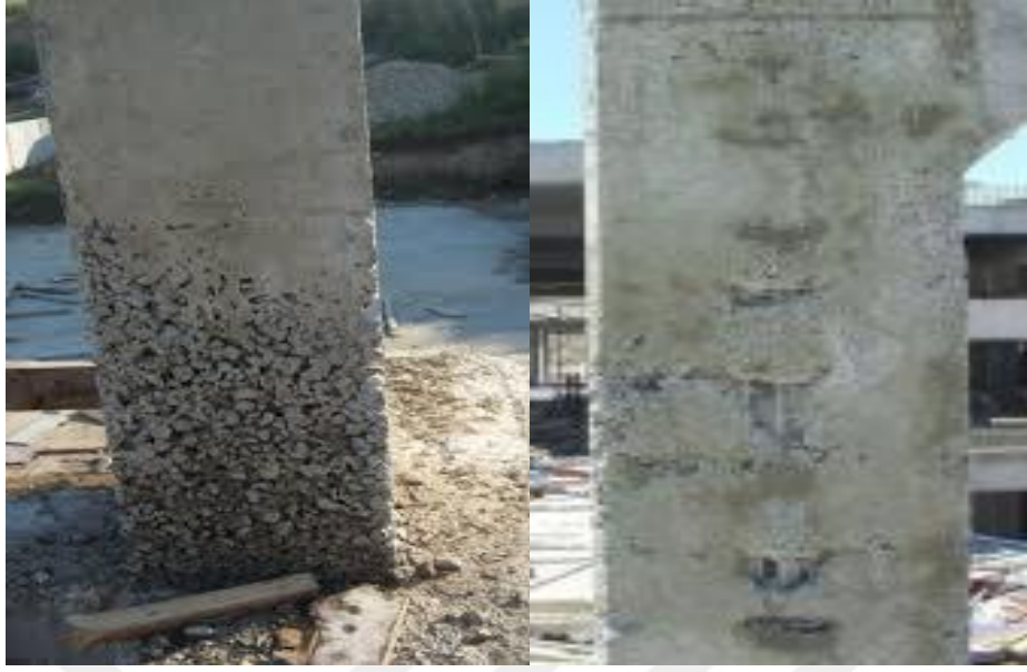
Şekil 2.2. Geleneksel betonda karşılaşılan bazı hatalar
