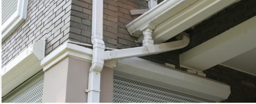
Fotoğraf 4.20. Plastik yağmur suyu oluğu ve boruları (URL-73, 2018)
