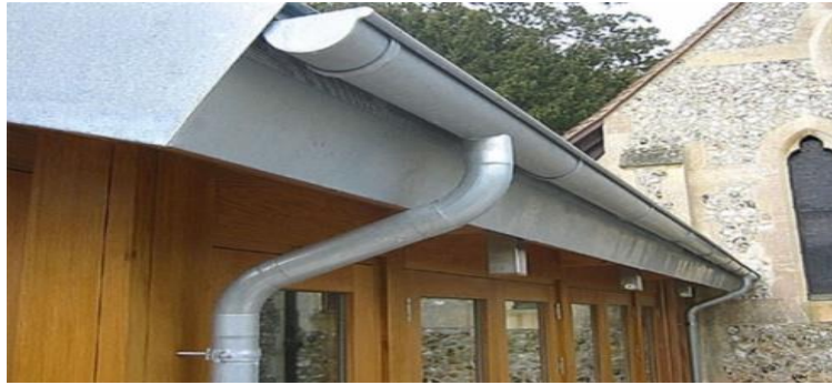
Fotoğraf 4.18. Galvanize yağmur suyu oluđu ve boruları (URL-71, 2018)
