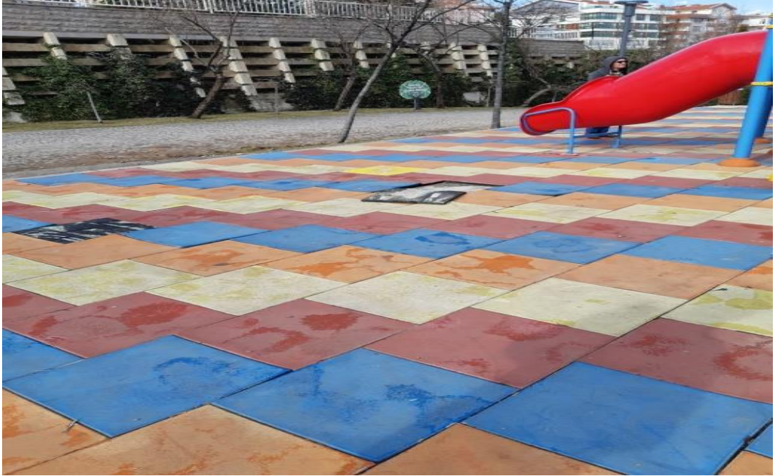
Fotođraf 4.7. Vadi Parkı’ndaki kauuk zemin hasarı
